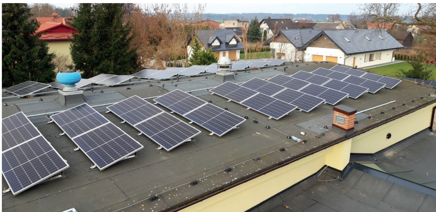
Fotowoltaika na dachu Szkoły Podstawowej w Kłodawie
