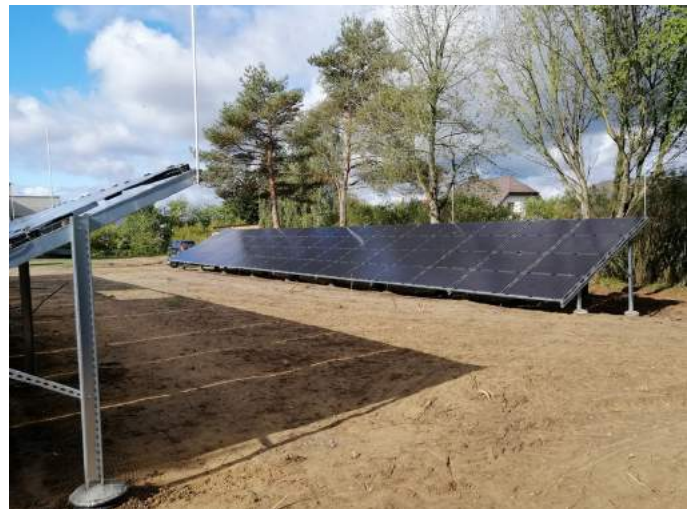
Instalacja fotowoltaiczna SUW Charzkowy
