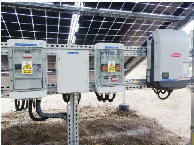
Instalacja fotowoltaiczna - szafa sterownicza, inwerter
